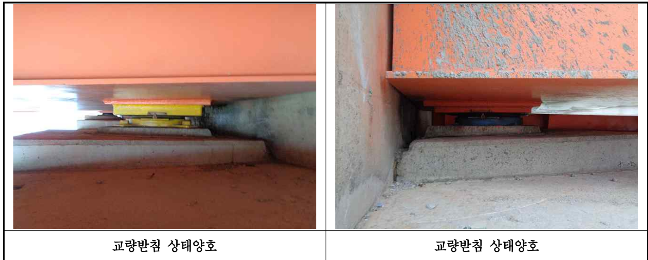
【사진 22.3.11】 교량받침 손상현황
