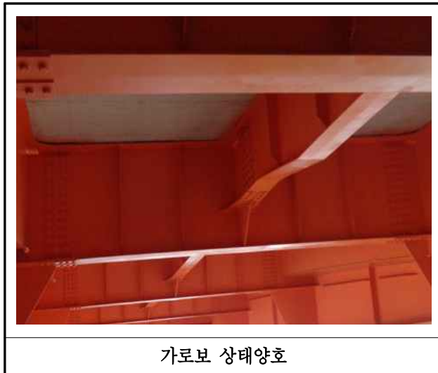
【사진 22.3.7】 가로보 손상현황
