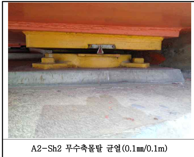
【사진 22.3.32】 교량받침 손상현황
