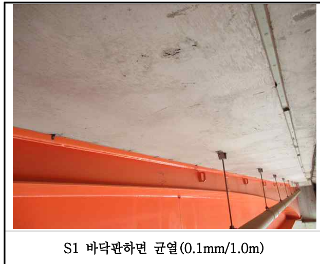
【사진 22.3.24】 바닥판하면 손상현황
